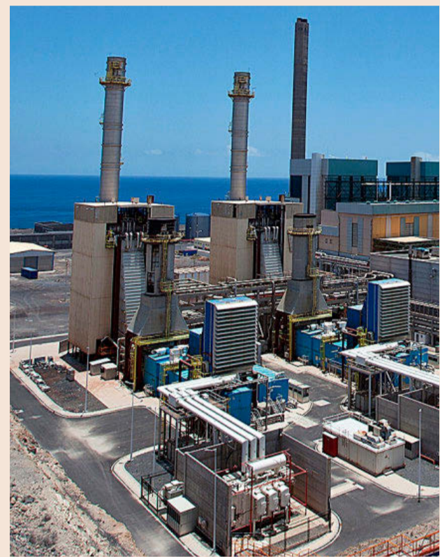
Planta de producción de energía eléctrica.
